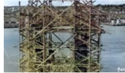
Voldsomme stillaser, vinsjer og tilsynelatende små anleggsarbeidere ved en av brupilarene nærmest Tromsdalen.
