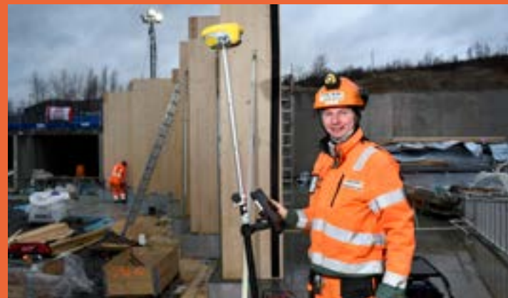
Mens anleggslederen er i Alta, sørger Mats Helander på byggeplassen i Kautokeino for at organisasjonen er oppdatert på utviklingen ved anlegget.
